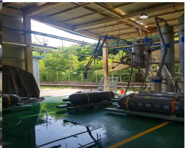
사고원점 좌·후면 샌드위치 패널 파손
