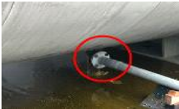
사고 저장탱크(TK-101H) 누출 부위
